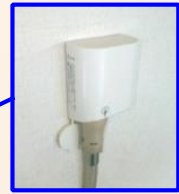
増設したガス栓の例
