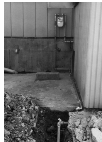
▲(応急仮設配管) 灯外内管 ポリエチレン管および白管転がし(戸建住宅)
