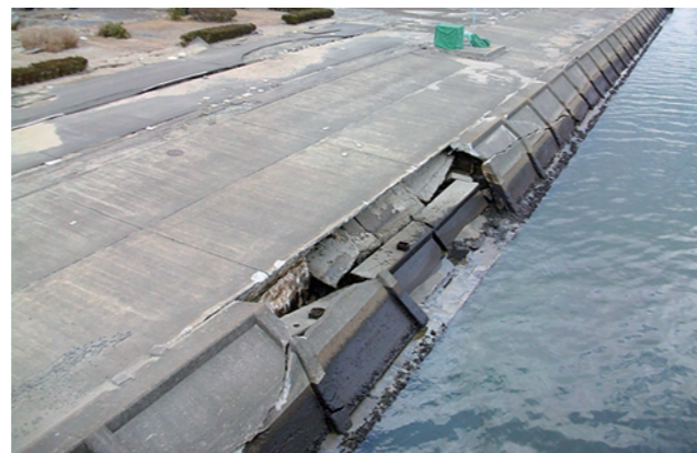
▲強固なはずの護岸も数カ所で法面が決壊し、路盤下部の土砂が流出して崩落。全長にわたって沈下し、多数の亀裂が発生した。また、保留装置も浸水により使用不能となった。
