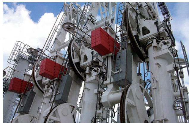
▲アン・ローディングアームは水没しなかったものの、地震の影響により旋回用固定ピンの変形や旋回角度のスレなどの被害を受けた。
