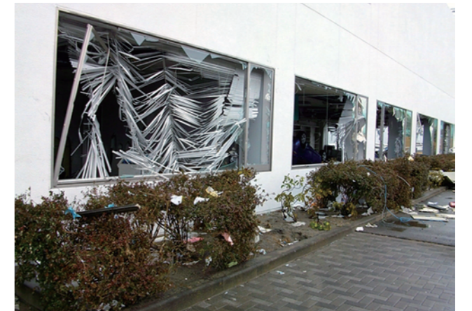
▲窓ガラス全面とブラインドが大破した事務所・コントロールセンター南側。建屋における窓の位置や大きさは今後の津波対策を検討する上での課題となった。
