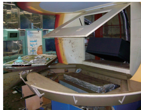
▲事務所・コントロールセンター、LNGプラザ、メンテナンスセンター、バスセンター、タンク計器室など、構内にある建物の1階部分はいずれも水没。執務室内には流された自動車が入り込み、LNGプラザの展示装置も損壊した。
