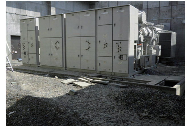
▲冠水した特高受電設備。第1変電室は床面の冠水のみで使用可能な状態であったが、第2変電室は扉が破損し、すべて冠水したため使用不能となり、電源喪失に陥った。
