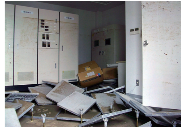
▲まくり上げられたフロアパネルが散乱する第2変電室内西側にあるタンク計器室。
