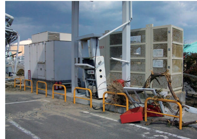
▲CNG充填所は事務所が流出。ディスペンサーも変形、大破した。
